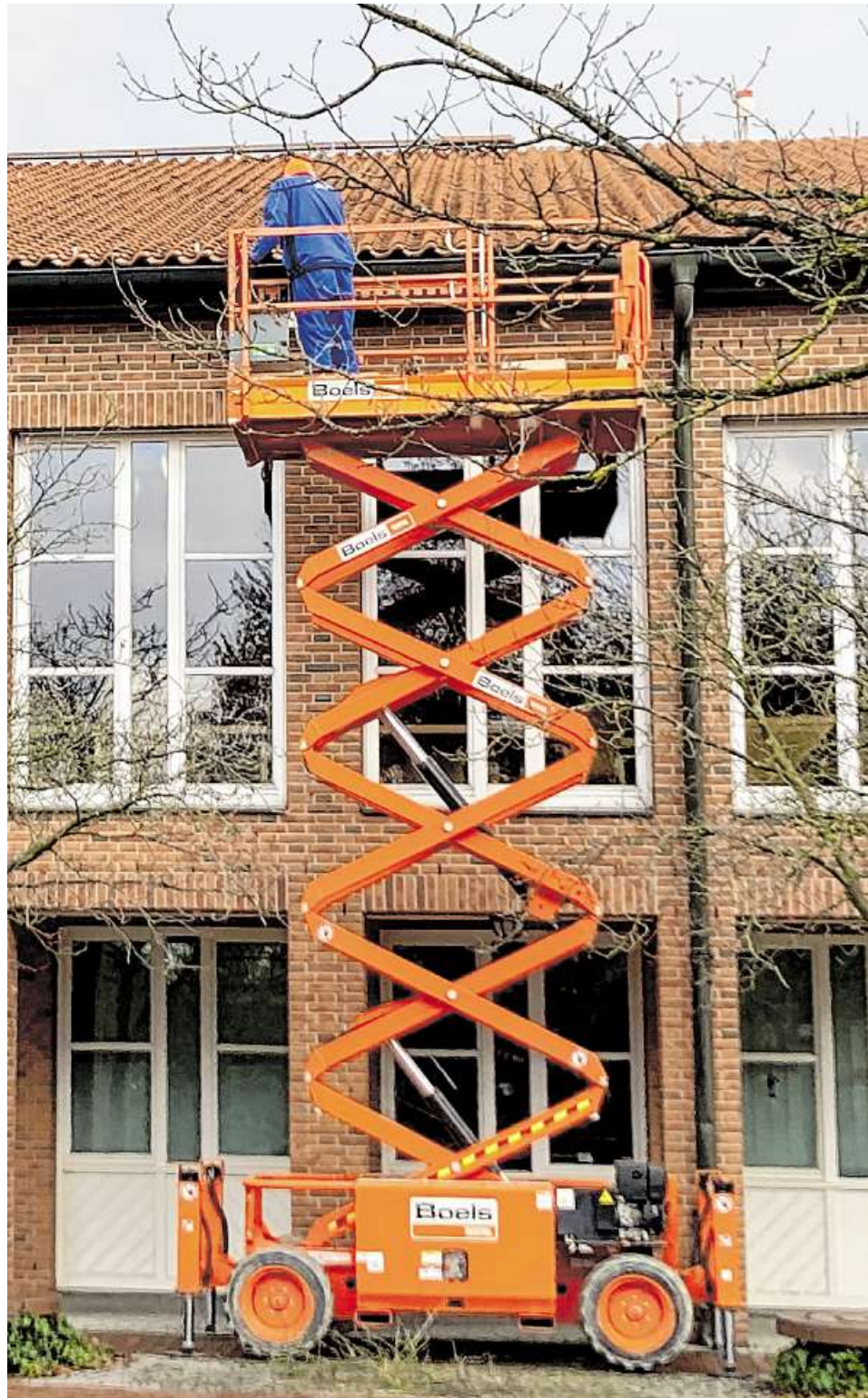
Unter anderem der Bereich über dem Ratssaal des Weyher Rathauses wird derzeit mit Solarmodulen ausgestattet. FOTO: ALEXANDRA PENTH
